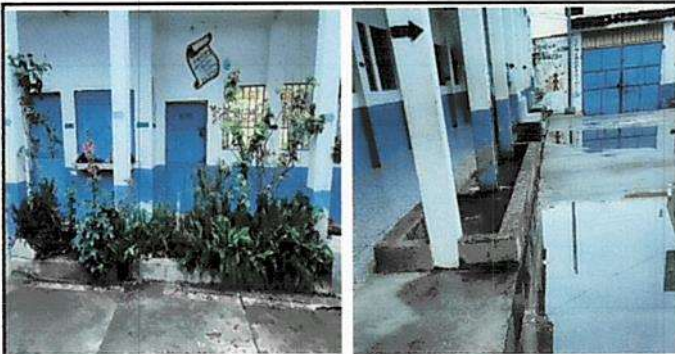
Foto 6: JARDINERA Y MESA DE ARENA A REPARAR
